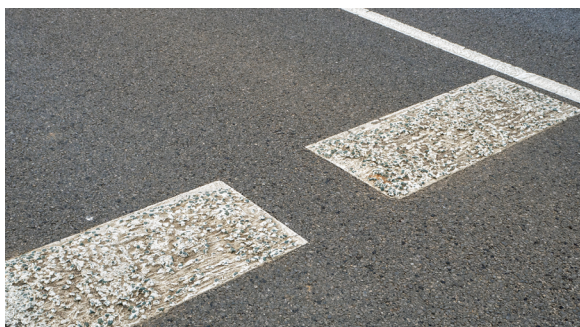
Détail d'une bande avec matériel qui engendre des vibrations
