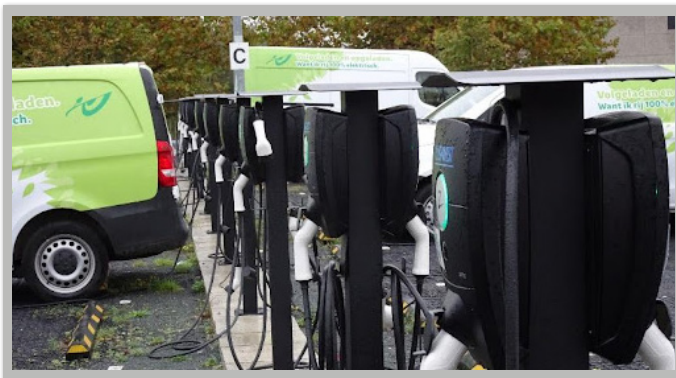
Elektro-Ladeinfrastruktur braucht Platz
