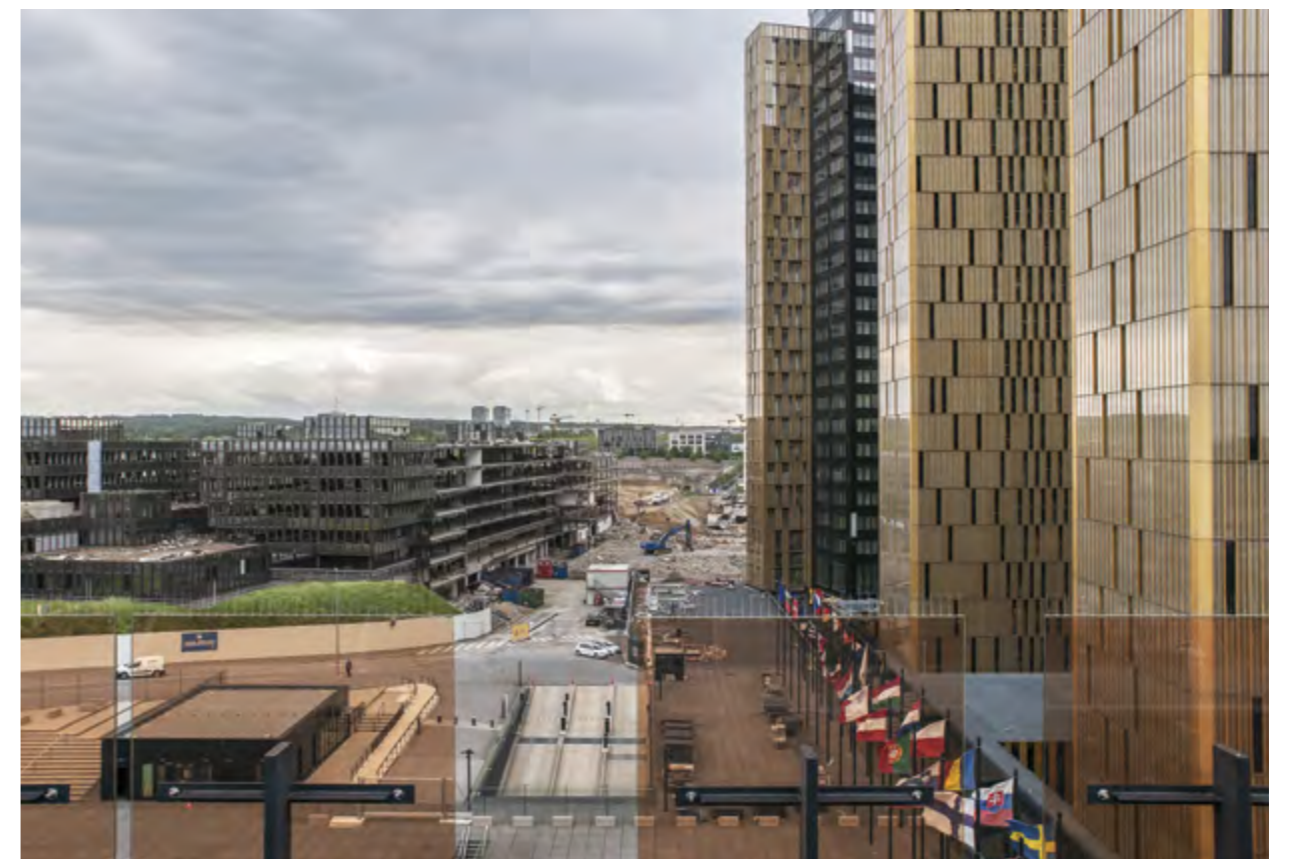
Le désamiantage et la démolition du bâtiment Jean Monnet 1 se sont déroulés entre mai 2017 et décembre 2019. The removal of asbestos and demolition of the Jean Monnet 1 building were carried out between May 2017 and December 2019.
