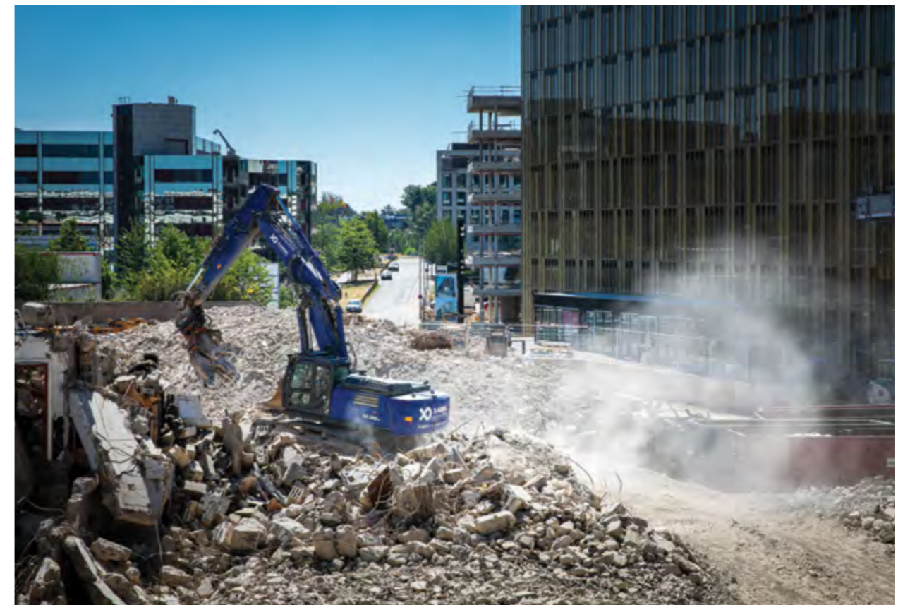
Quelque 94 000 tonnes de béton concassé et 5500 tonnes de ferrailles ont été enlevées lors de la démolition. Around 94 000 tonnes of crushed concrete and 5 500 tonnes of scrap metal were removed during demolition.
