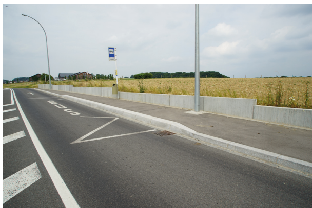
Arrêt en ligne
