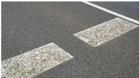
Détail d'une bande avec matériel qui engendre des vibrations
