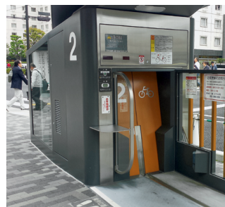
Porte d'entrée du système automatisé (Osaka)
